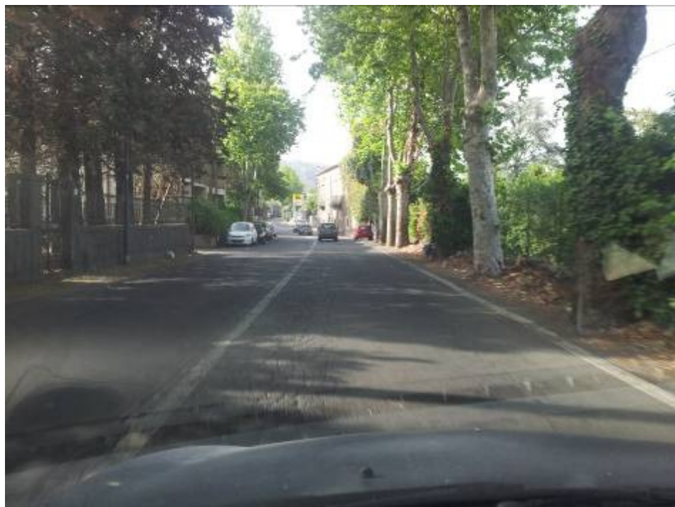
manto usurato lungo della strada
