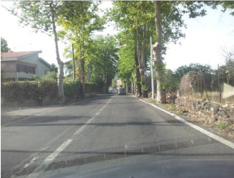
manto usurato lungo della strada
